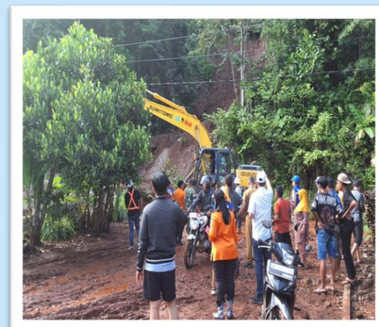
Penanganan Tanah Longsor di Desa Ussu Kec. Malili, 28 Juli 2025
